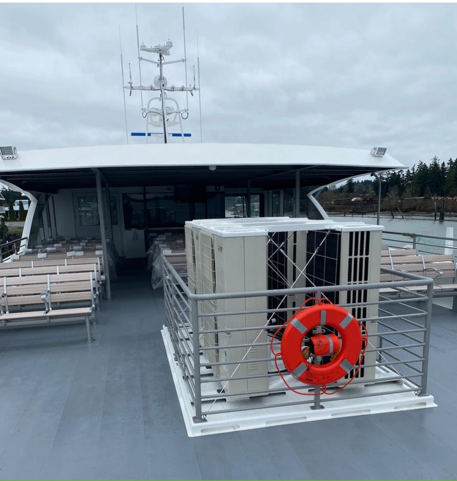
M.V. DORADO HVAC AREA
